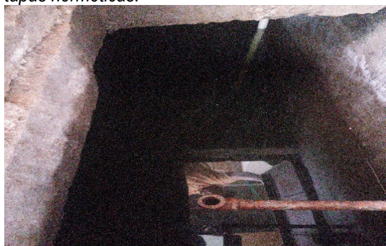
Fotografía 4. Tanque de almacenamiento con agua. Mas de un 90% de contenido.
