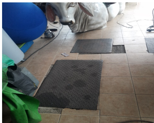
Fotografía 2. Tanque de almacenamiento de agua. Sin tapas herméticas.
